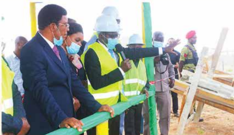
Waziri Mkuu wa Jamhuri ya Muungano wa Tanzania Mhe. Kassim Majaliwa Majaliwa (Mb) akipokea wasilisho la Mradi wa Jengo la Ofisi ya Rais, Menejimenti ya Utumishi wa Umma na Utawala bora kutoka kwa Mtendaji Mkuu wa TBA Arch. Daud Kondoro kabla ya uwekaji wa jiwe la msingi la ujenzi la ujenzi wa Ofisi za Wizara zote kwenye mji wa Serikali Mtumba jijini Dodoma.
